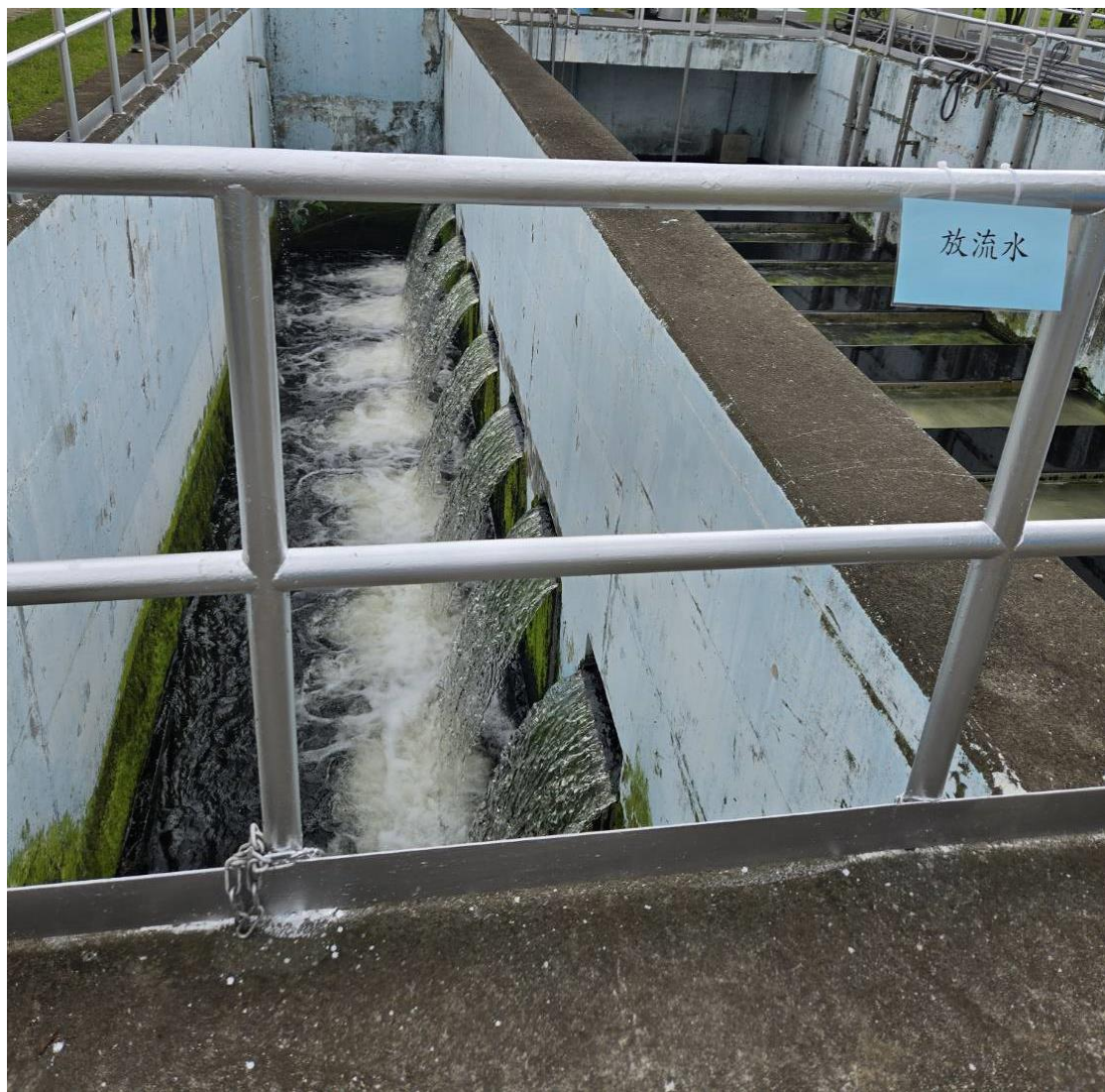
圖三: 上圖為花蓮地區水資源處理中心，每日汙水處理量約5萬噸，落差約1.5公尺。
